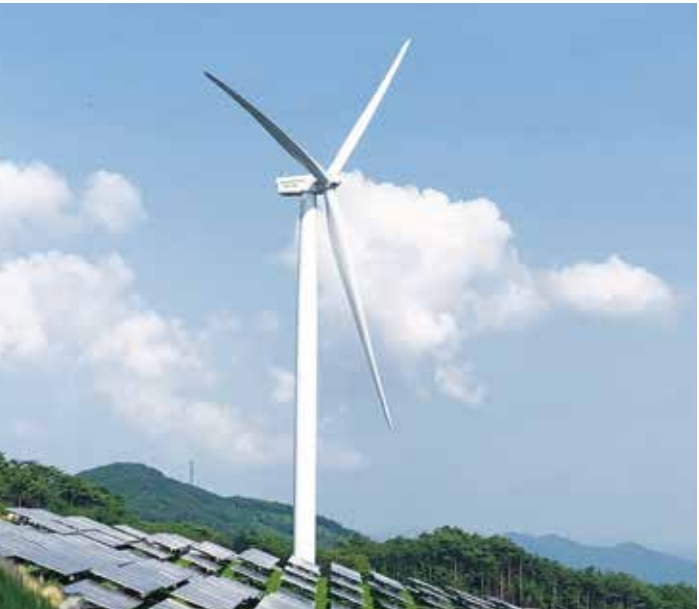
西サイトに建設した風車は1基当たり3.2MWの発電機出力を誇る
