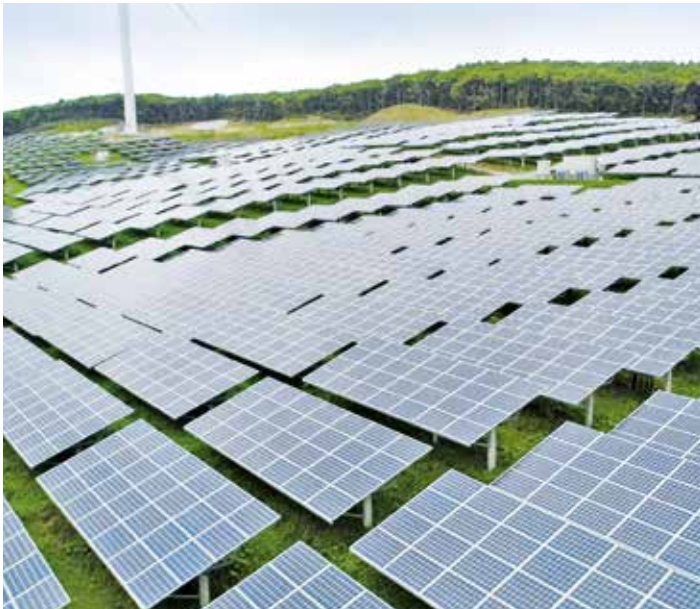
太陽光パネルは3サイトに分けて設置され、合計発電出力は10MW
