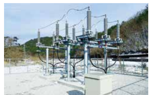
福島送電(株)川内南分岐所へ接続
